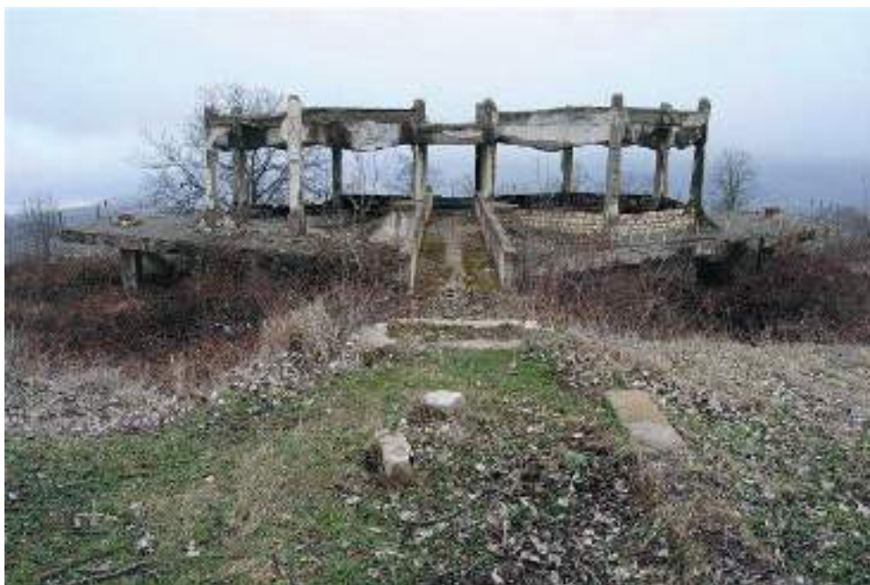
“Turş-su” mineral su qalereyası binası. “Şuşa” sanatoriyasının istirahət evinin ərazisi. Здание питьевой галереи «Турш су». Территория дома отдыха санаторий “Шуша”.
